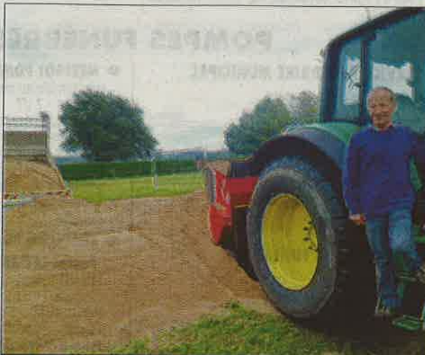
RÉFECTION DU TERRAIN DE FOOT. Un aperçu des travaux de la réfection de la pelouse du stade.
